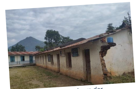
Erdbebenschaden an einem der Schulgebäude
